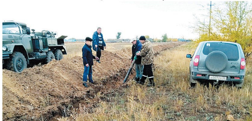
До полного завершения работ на водопроводе в Веселом Первом остались считанные дни.
